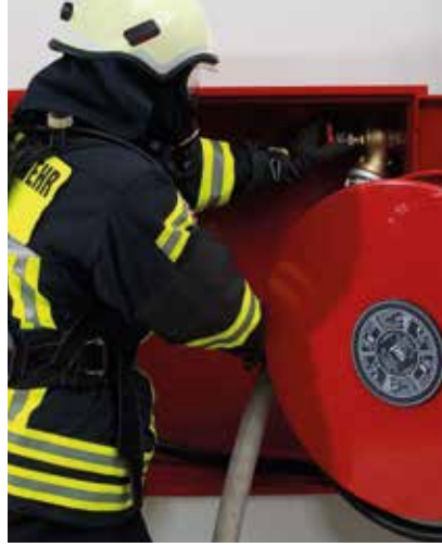
Yangın dolabı: Bina içinde doğrudan elle müdahale için bulundurulur.
